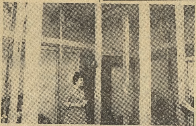
Stemple trzymające strop w hallu, skąd prowadzą wejścia do mieszkań wielu rodzin w domu przy ul. Smoleńsk.
