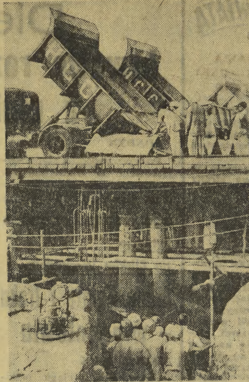
Pomoc ZSRR dla Indii W zbudowanym i uruchomionym przy pomocy specjalistów radzieckich kombinacie metalurgicznym w Bhillai (India), prowadzone są obecnie prace przy rozbudowie fabryki, której moc produkcyjna wyniesie 2,5 miliona ton stali rocznie. Na zdjęciu: betonowanie drugiej połowy fundamentu nagrzewni dymu wielkiego pieca nr 3. W ciągu 25 godzin bez przerwy wjeżdżały na pomost samochody - wywrotki, wydławujące rozrobiony cement.
